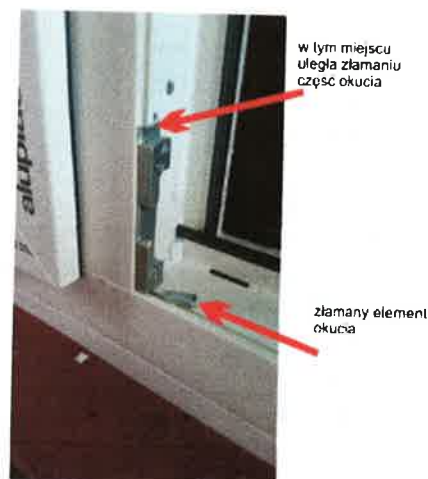
Zdjęcie. Uszkodzenie elementu okucia w trakcie badania.
